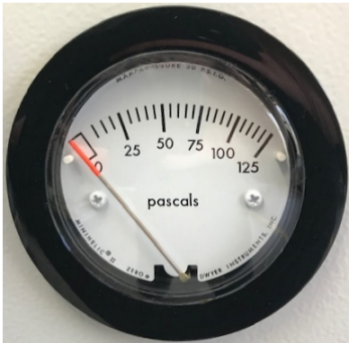
Abbildung 23: Analoge Druckanzeige (Manometer) zur Überwachung der Druckluftspülung an der Gerätefront
